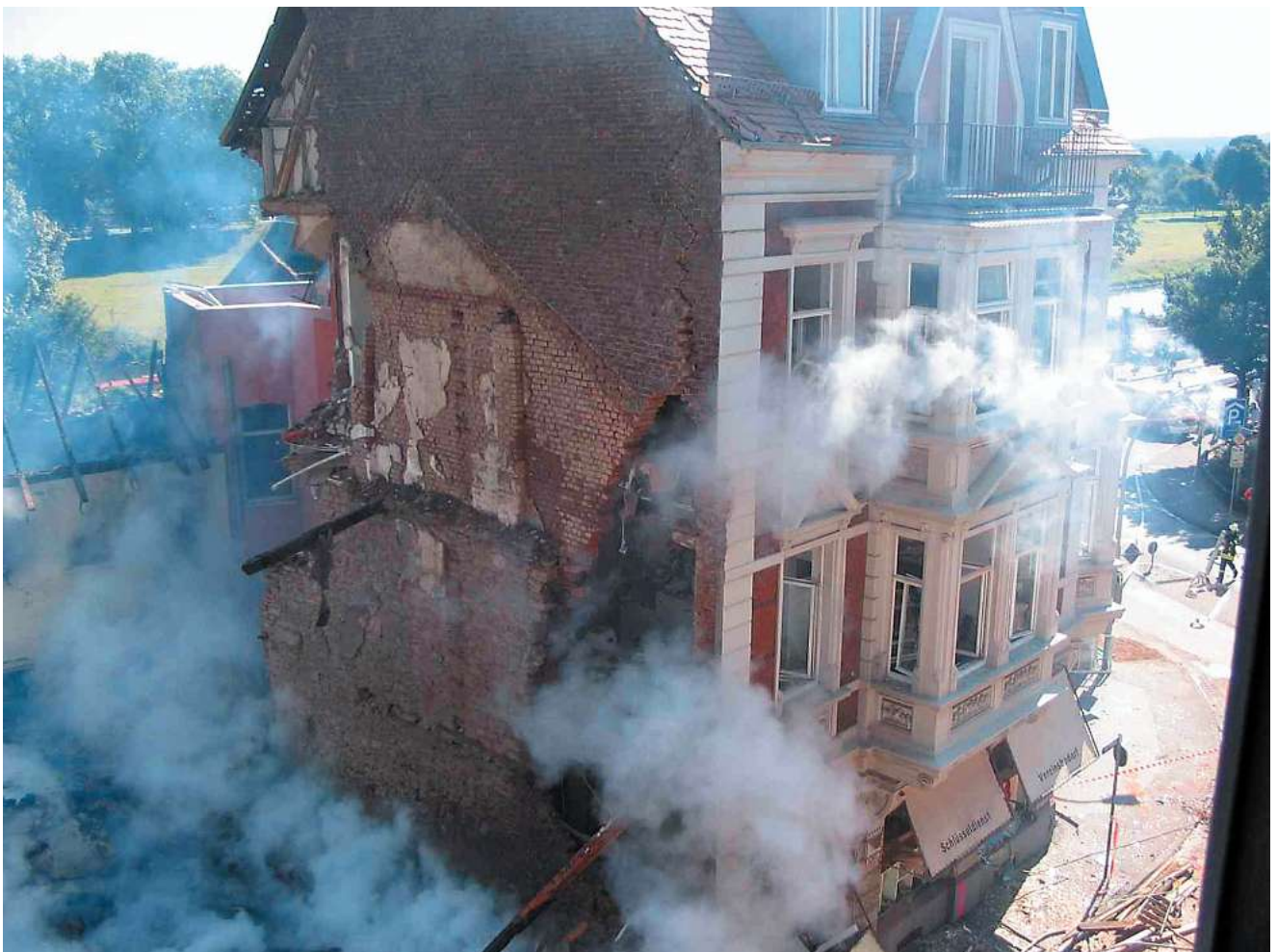
Vom Haus »Am Rathaus 11« blieben, wie hier deutlich zu erkennen ist, nur noch die Reste der Giebelwand zum Nachbargebäude stehen. Diese wurde am 20. September 2005, einen Tag nach der Explosion, durch eine Firma abgerissen.
